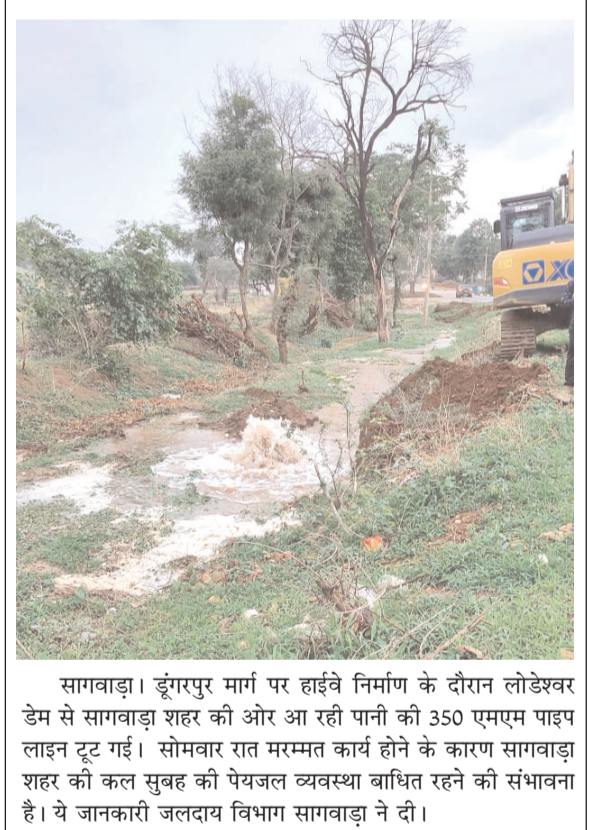
सागवाड़ा। डूंगरपुर मार्ग पर हाईवे निर्माण के दौरान लोडेश्वर डेम से सागवाड़ा शहर की ओर आ रही पानी की 350 एमएम पाइप लाइन टूट गई। सोमवार रात मरम्मत कार्य होने के कारण सागवाड़ा शहर की कल सुबह की पेयजल व्यवस्था बाधित रहने की संभावना है। ये जानकारी जलदाय विभाग सागवाड़ा ने दी।
